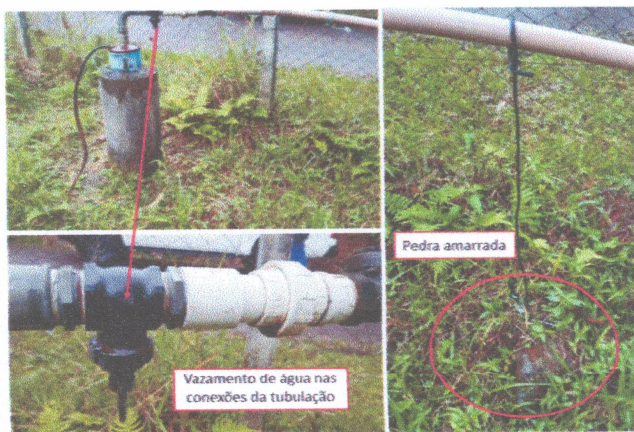
Figura 10 - Condições sanitárias do poço subterrâneo.
