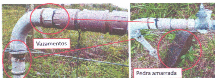
Figura 3 - Problemas estruturais na tubulação de saída da água captada.
