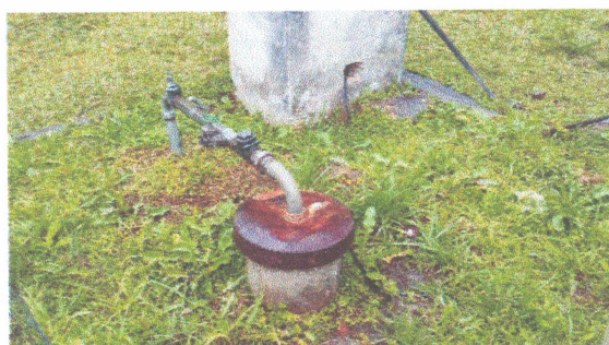
Figura 7 - Poço subterrâneo da SAC Ressaco.
