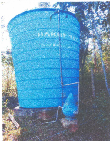
Figura 5 - Reservatório da SAC Espigão.
