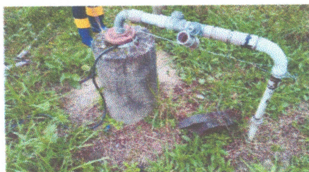
Figura 2 - Condições sanitárias do poço subterrâneo da SAC Espigão.
