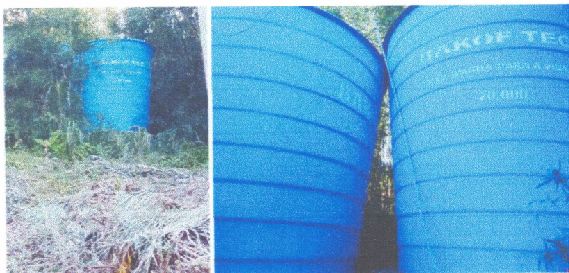
Figura 12 - Reservatórios da SAC da Linha Becker.
