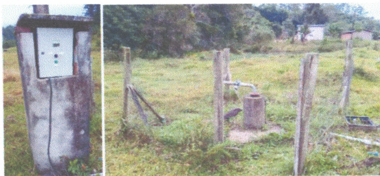
Figura 1 - Condições sanitárias da SAC Espigão.
