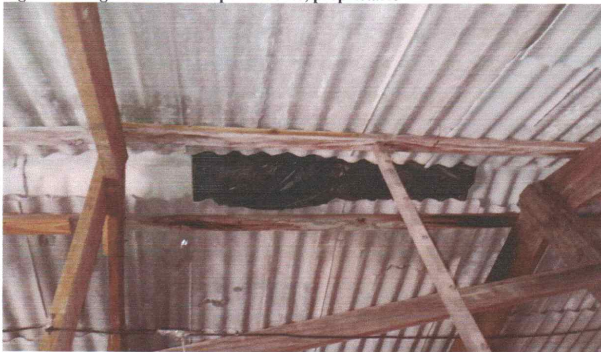
Figura 1. Imagem do telhado após o evento, proprietário
